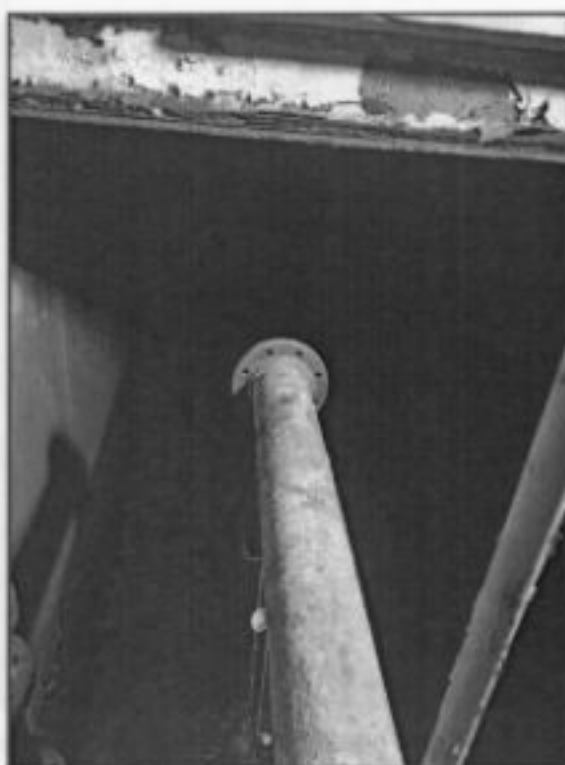
Figura 38 - Stato di conservazione degli elementi metallici.
