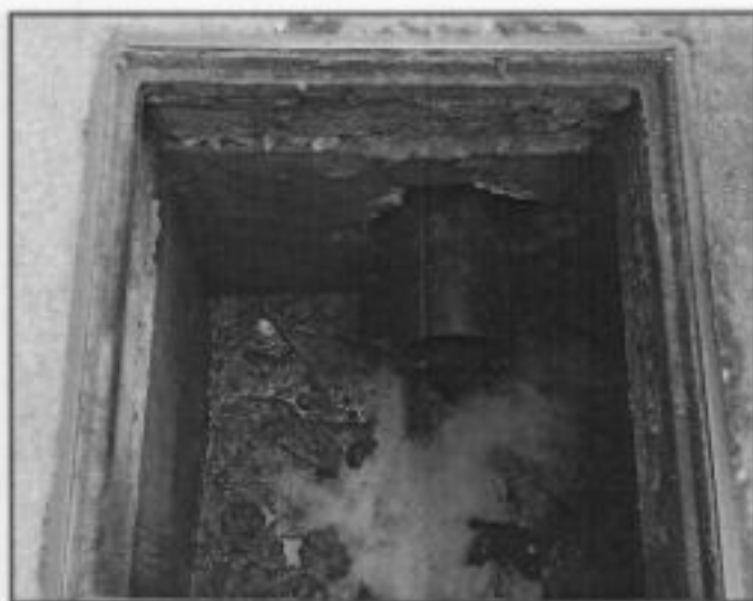
Figura 50 - Punto di Scarico nel pozzetto fognario
