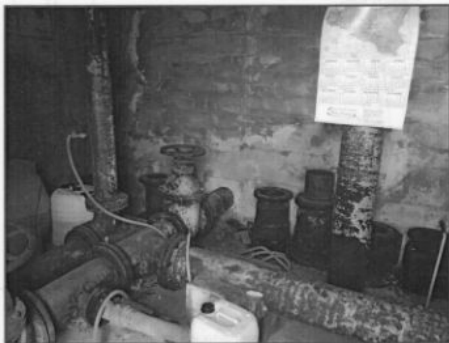
Figura 31 - Camera di Manovra (presa e scarico comparto in destra idraulica)
