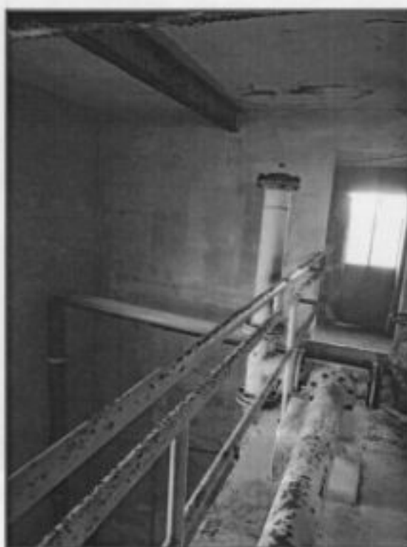
Figura 39 - Stato di conservazione degli elementi metallici.
