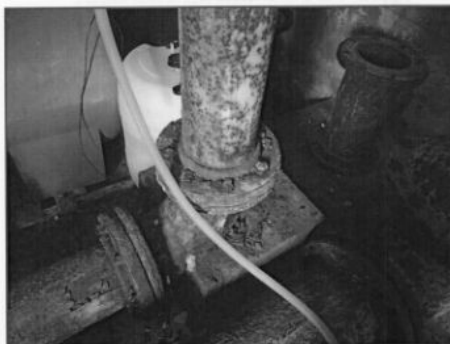
Figura 37 - Stato di conservazione della tubazione (sfaldamento della struttura)
