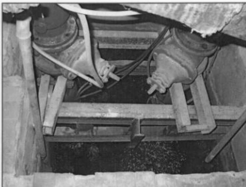
Figura 20 - Pozzetto di adescamento con elettropompe.
