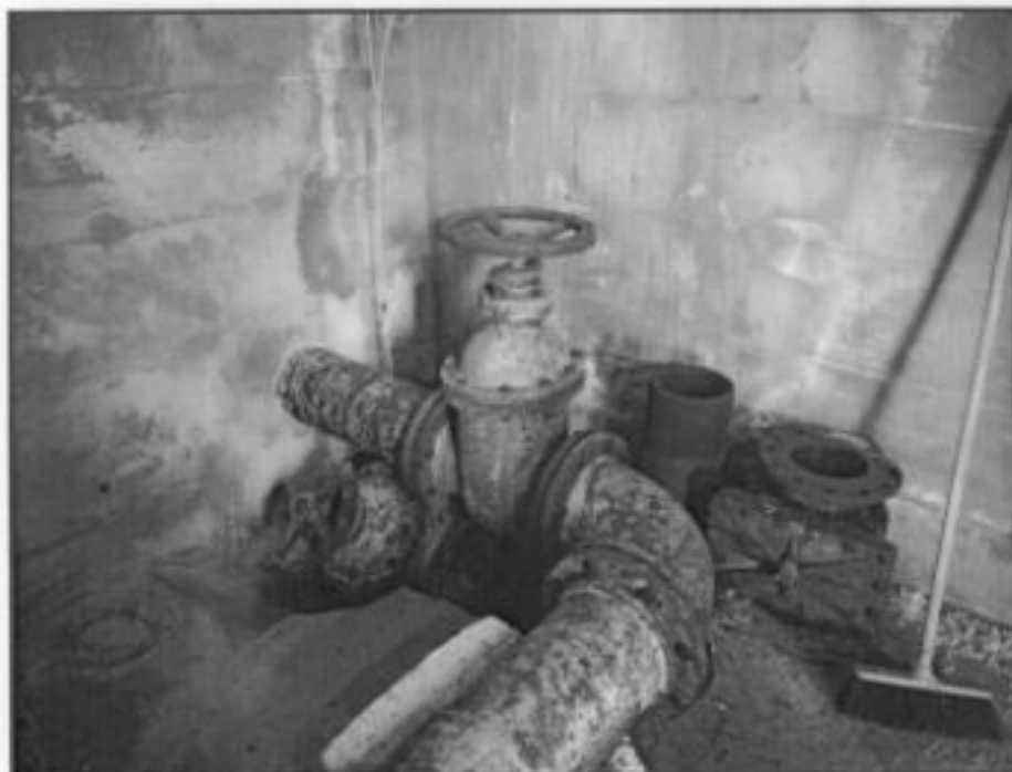
Figura 32 - Camera di Manovra (presa e scarico comparto in sinistra idraulica)
