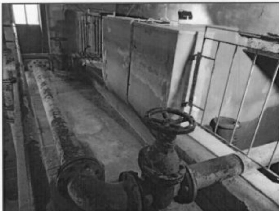
Figura 36 - Particolare tubazioni di arrivo ai due comparti
