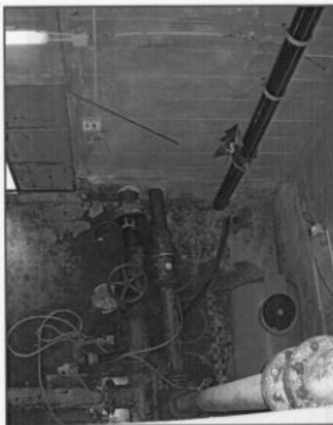
Figura 33 - Particolare tubazioni adduttrici e di avvicinamento
